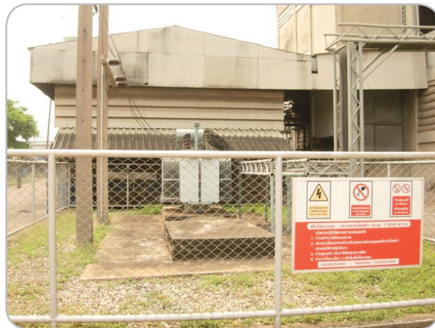
ภาพที่ 5.7 แสดงการติดตั้งหม้อแปลงไฟฟ้าแบบตั้งพื้น
