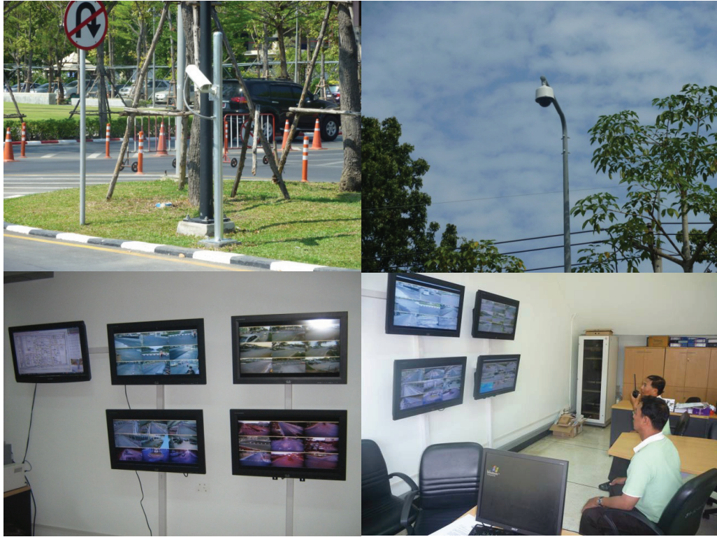
ภาพที่ 5.11 แสดงห้องควบคุมที่ติดตั้งจอภาพดูการทำงานร่วมกับ CCTV
