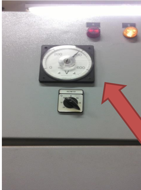
ตู้หมายเลข 1 ควบคุมระบบแสงสว่าง
