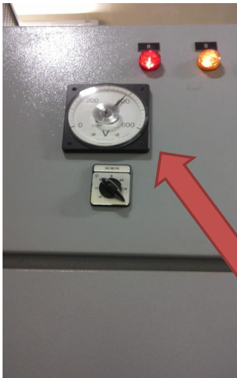
ตู้หมายเลข 2 ควบคุมระบบปรับอากาศซิลเลอร์
